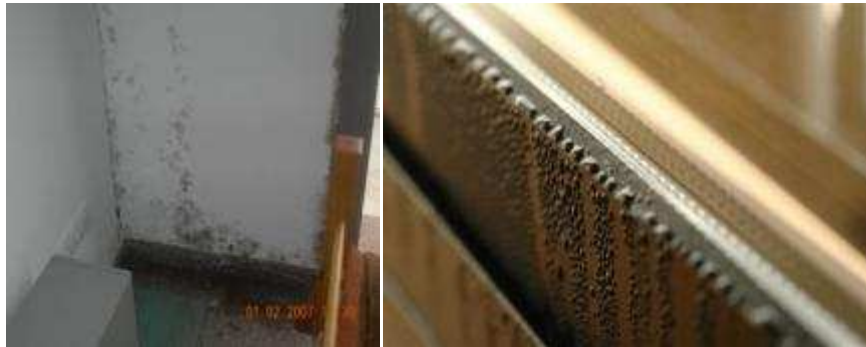
Fig. 29 Humitats a l'interior dels habitatges en edificis de recent construcció, per condensacions intersticials (esquerra) o condensacions superficials (dreta) degudes a problemes termohigromètrics en les solucions de façanes. Fonts ADIGSA i pròpia.
