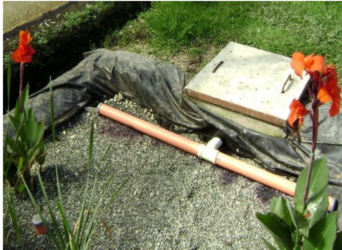
Fotografía 2. Vista de la tubería perforada para la distribución del efluente y la caja de distribución o arqueta. Fuente: Ángel Gallegos.
