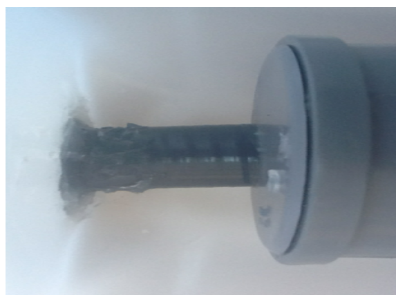
Fotografía 14. Para evitar fugas se debe sellar la conexión entre la tubería de drenaje y la salida del deposito. Fuente: L. Aguilar.
