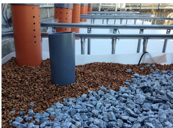
Fotografía 19. Vista del humedal con medio filtrante de corcho y una capa de 20 cm de grava de 16 mm para evitar que flote. Fuente: L. Aguilar.
